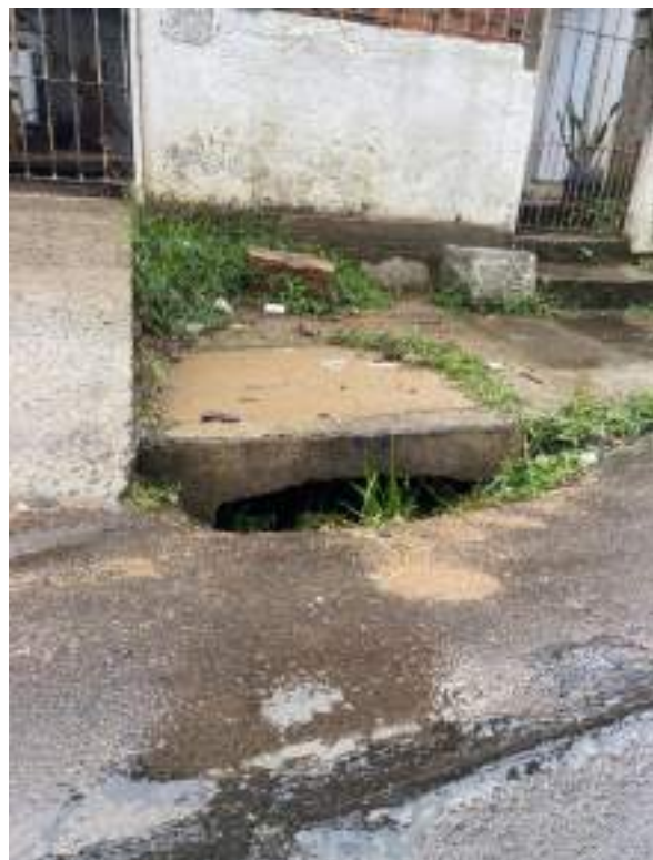
A imagem ilustra o relato de que o recapeamento asfáltico encobriu significativamente as entradas das bocas de lobo, dificultando ainda mais o escoamento da água.
