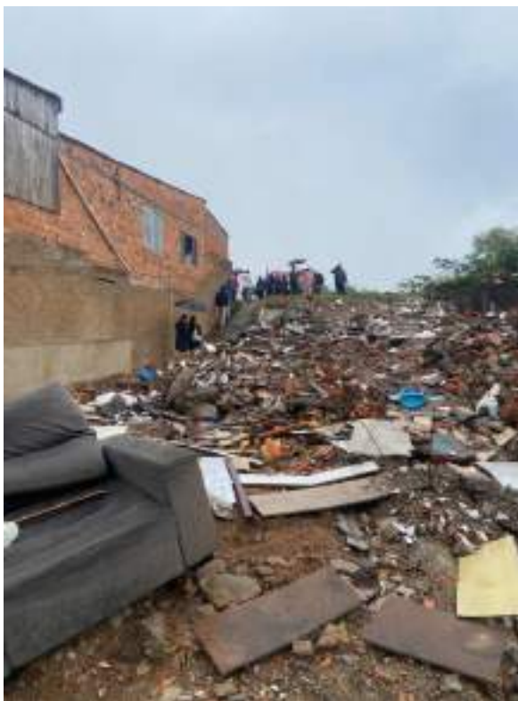
A imagem ilustra a denúncia da demora do recolhimento dos entulhos após a demolição das casas
